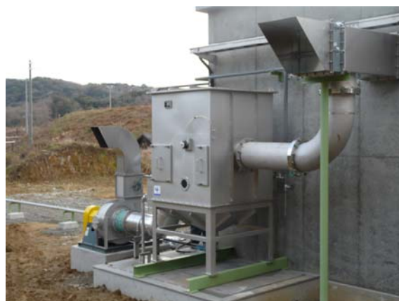
密閉試験場の排ガス処理設備
